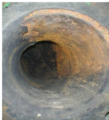
Figura 2. Falha no revestimento de polietileno.
