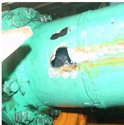
Figura 1. Local da falha por corrosão.
