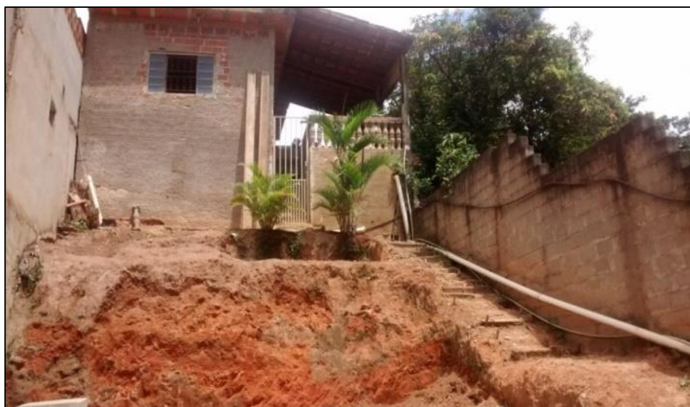
Figura 6. Moradia situada em áreas de risco de escorregamento – Águas do Canindú I.
